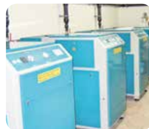
Kompressoren im Betriebsraum
