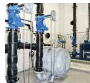
GULLICOMB® mit Freistromradpumpe
